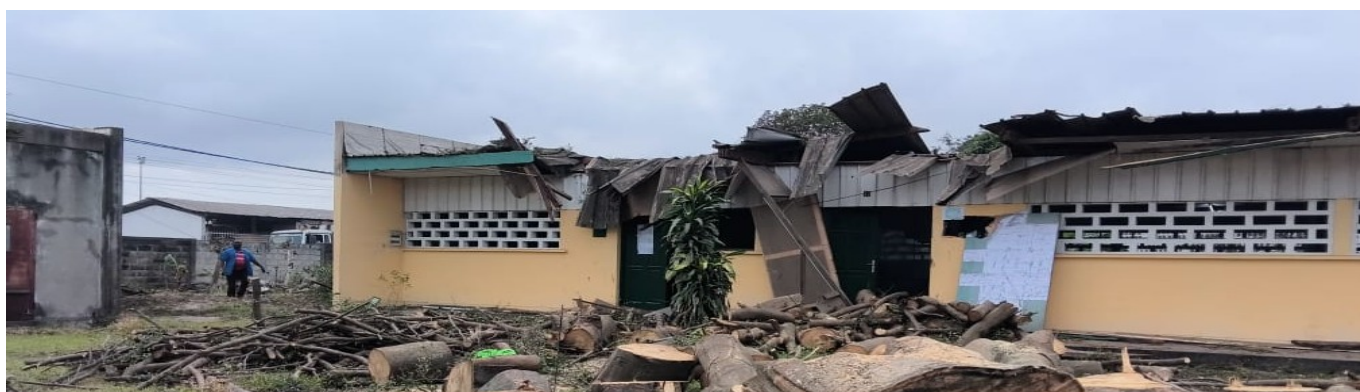
Bâtiment salle de classe détruit par un arbre
